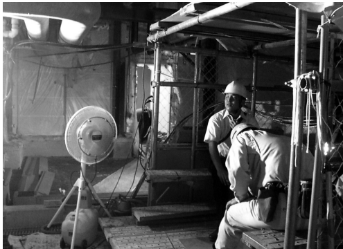
■工場内の冷房
