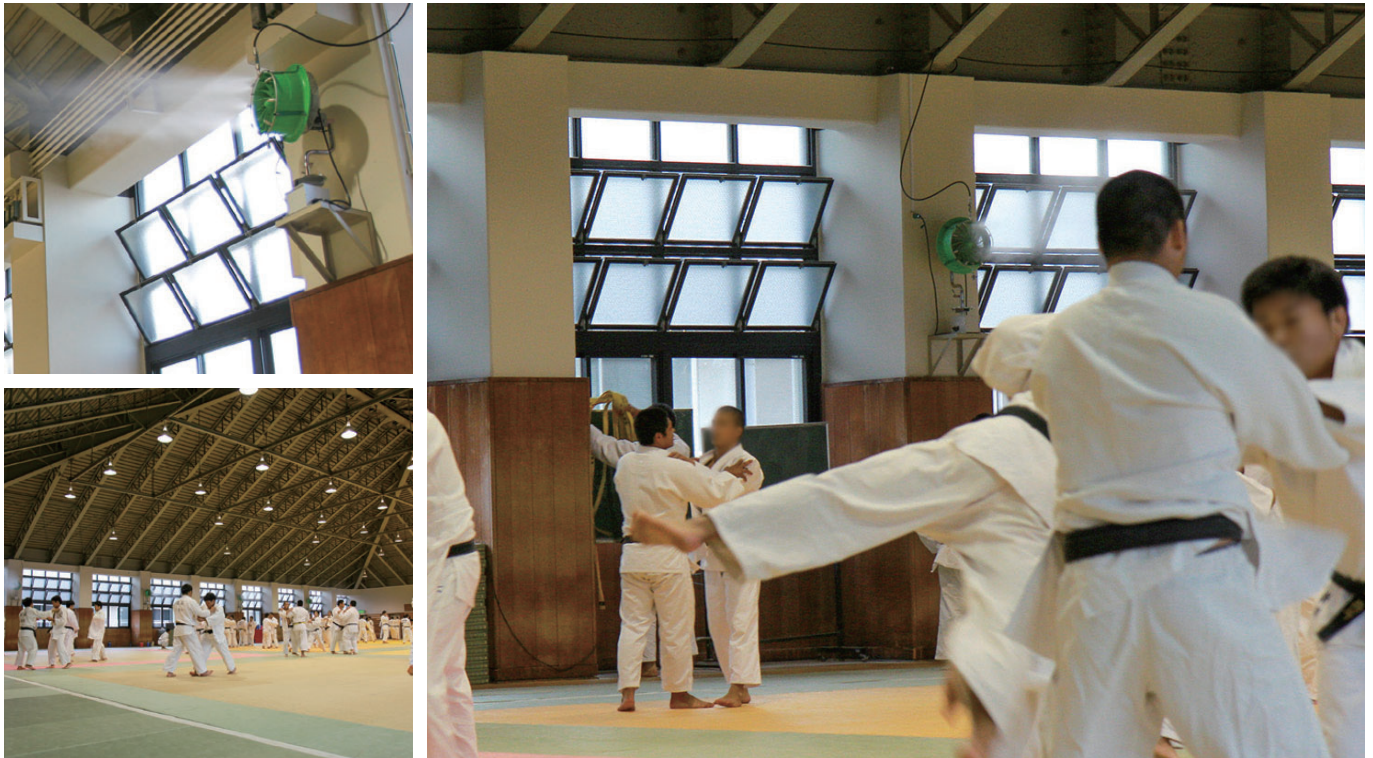
▲大学の柔道場に導入。非常に面積が広く高さのある道場でも、室温が大きく低下、練習効率は格段に向上している。
