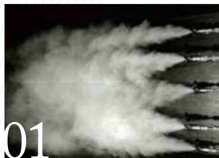
01 空調機内加湿の様子
