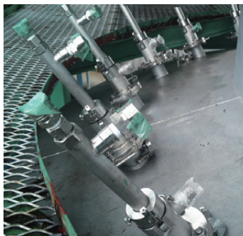
冷却塔本体ノズル設置箇所
