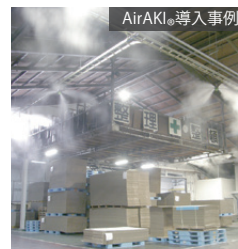
AirAKI®導入事例 段ボール製造工場
