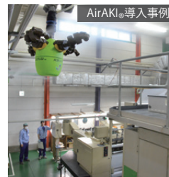
AirAKI®導入事例 オフセット印刷工場
