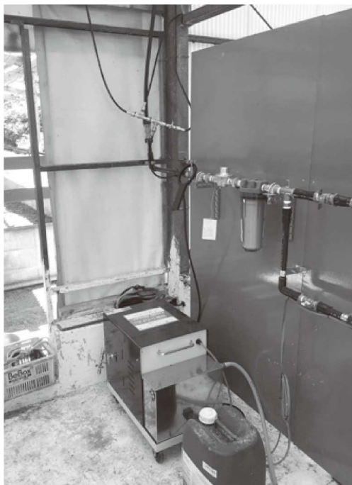
写真3 上水や井水を噴霧ユニットに送水するためのポンプユニット
