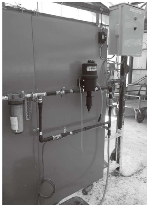
写真4 噴霧のON/OFFを自動管理する制御ユニット
