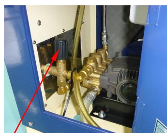
圧力調整バルブ 注意: 奥に回転体あり
