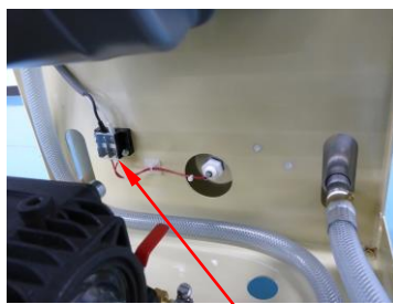
湯水センサー 接続端子台
